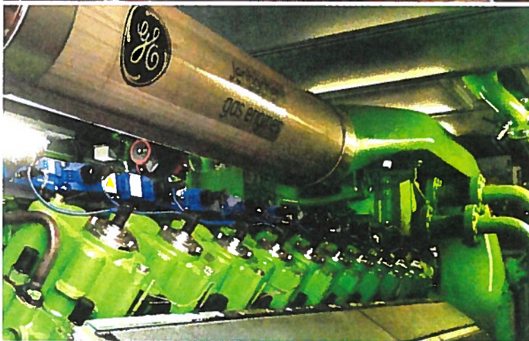
Das BHKW J620 von Jenbacher leistet 3 MW elektrisch und 3 MW thermisch
