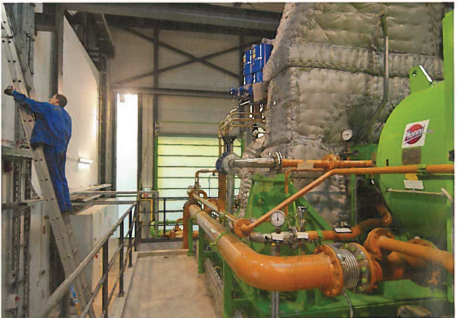
Moderne Zeiten: Der Knödelhersteller Pfannl nutzt Strom und Wärme aus einer mechanisch-biologischen Müllaufbereitung.
